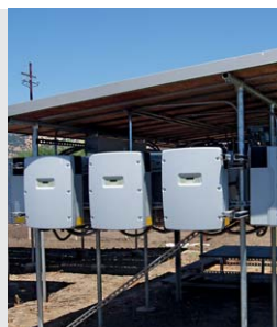
String-Wechselrichter einer PV-Freiflächenanlage
