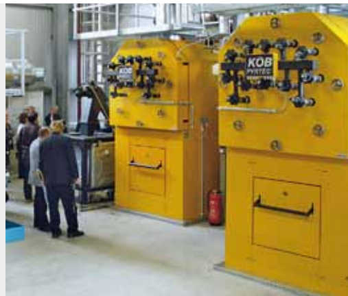
Optimale Prozesssteuerung in einem Biomasse-Heizwerk
