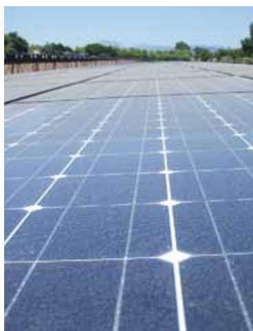
Photovoltaikanlage im Betrieb
