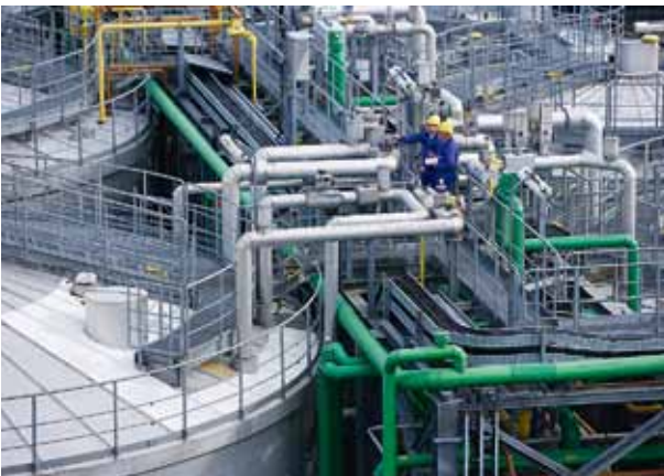
Thermische Verfahrenstechnik mit entsprechender Abwärme
