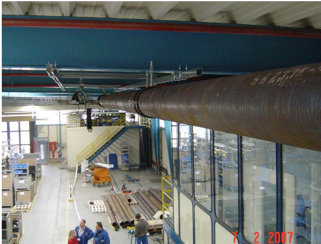
Abb.1: Die Montage der Ringleitung, die sämtliche Produktions- und Arbeitsbereiche in der Grammer AG vernetzt
