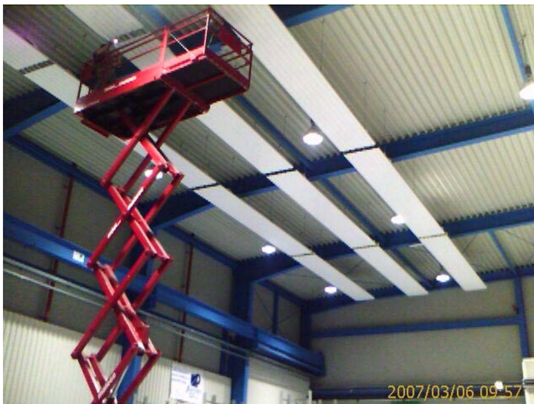
Abb.2: Zentral geregelte Deckenstrahlplatten sind über Unterstationen mit der Ringleitung verbunden und beheizen unter Berücksichtigung des Abwärmeeinfalls bedarfsoptimiert die Produktionshallen
