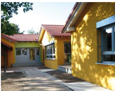
Bild 4: Die Sanierung der Außenwand mit Hilfe der massiven Wärmedämmfassade aus Ziegeln macht es möglich das Gebäude energetisch auf Neubauniveau anzuheben.
