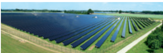
In den USA plant Gehrlicher Solar ebenfalls Solarparks auf Freiflächen wie etwa den Energiepark Lauingen – das größte Photovoltaik-Kraftwerk Schwabens
