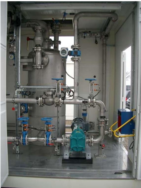
Bild: Innenansicht Thermische Hydrolyse mit Verrohrung
