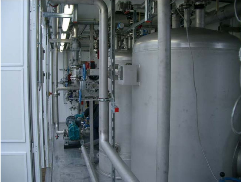
Bild: Innenansicht der Behälter Thermische Hydrolyse
