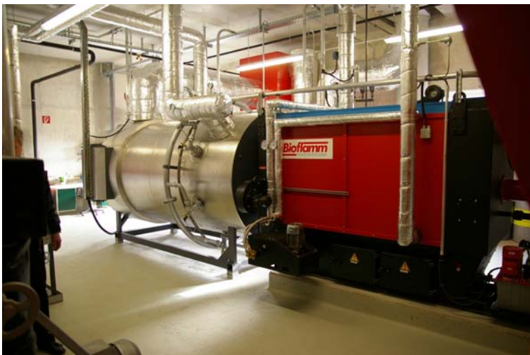
Das Herzstück: Biomassefeuerung und Thermoölerhitzer
